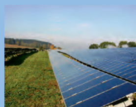
Der Conergy Solarpark in Baar ist einer von sechs Parks im Landkreis Aichach-Friedberg.
